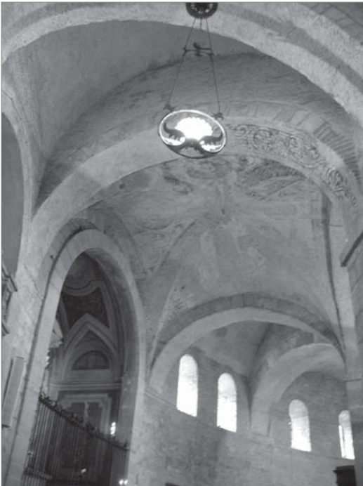
Figs. 241, 242 y 243. Arriba. CRIPTA DE SAINT BENOÎT SUR LOIRE, FLEURY (Francia, siglo XI). Bóveda de un tramo de la planta del deambulatorio con luneto curvo recayente al lado corto y luneto apuntado al exterior. Ver que este último presenta su vértice no correspondiente a la clave de la bóveda, pero que los lados de ambos lunetos, bien que sin contacto alguno, se alinean. Centro. Croquis de plantas cenitales de bóvedas de arista sobre tramos trapezoidales de un deambulatorio. Abajo. LA ROTONDA DE BRESCIA (Italia, siglo XI). Ver cómo la regularización de los tramos del deambulatorio exterior a tramos cuadrados, implica la disposición de tramos triangulares cubiertos por bóvedas de geometría compleja que se adaptan a ellos.
